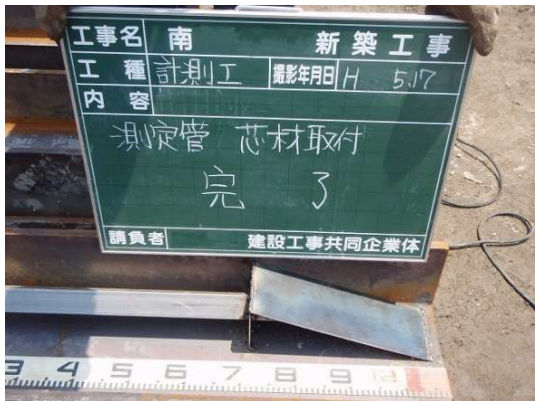
傾斜計測定管（下端）
